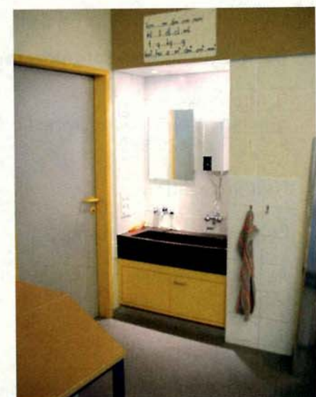
Klassenzimmer neu mit Warmwasser (Musterzimmer)
